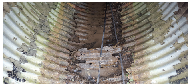
Dieses alte Metallwellrohr-Durchlass war in vielen Bereichen völlig durchkorrodiert.
