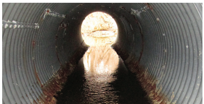
78" Metallwellrohr war korrodiert und defekt.
